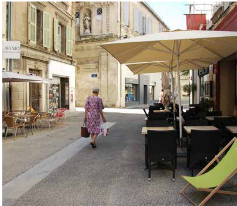
Un béton désactivé composé de granulats basaltiques remplace aisément un enrobé. De plus, il repose sur la structure existante (dont la portance a été vérifiée) et ne nécessite donc pas une excavation plus importante du sous-sol.
