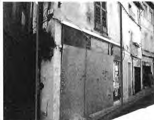
Façade depuis l'incendie
